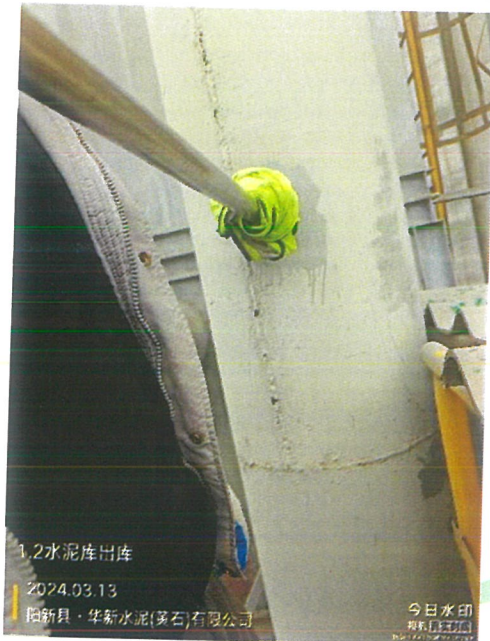
DA028 1、2 水泥库出库排气筒采样口◎12
